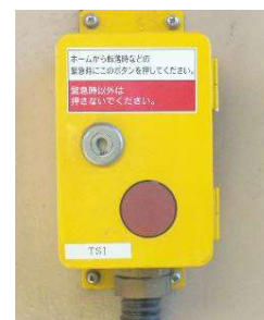
非常通報ボタン
