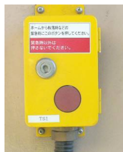
非常通報ボタン
