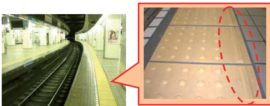
内方線付き点状ブロック
