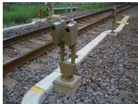
踏切障害物検知装置
