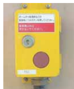
非常通報ボタン
