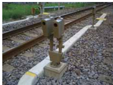
踏切障害物検知装置
