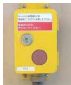
非常通報ボタン
