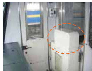
運転状況記録装置
