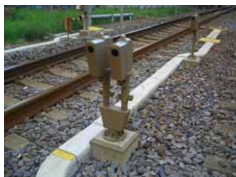
踏切障害物検知装置
