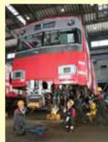
車両検査の様子
