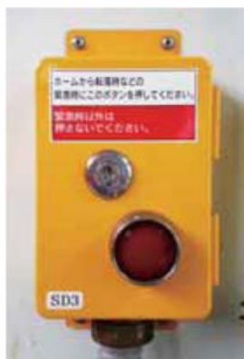
列車非常通報ボタン
