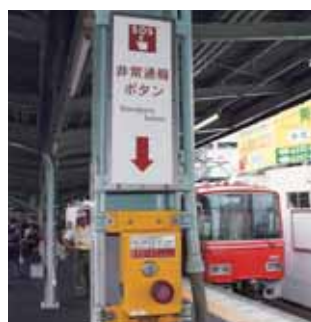
列車非常通報装置
