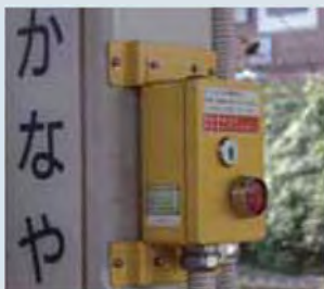
列車非常通報装置
