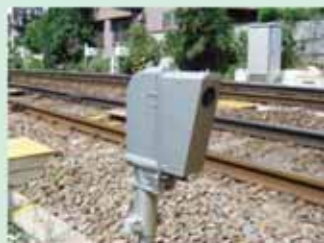
踏切障害物検知装置
