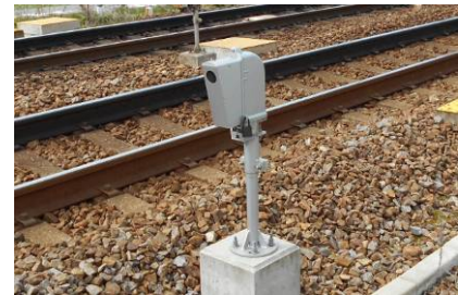
踏切障害物検知装置
