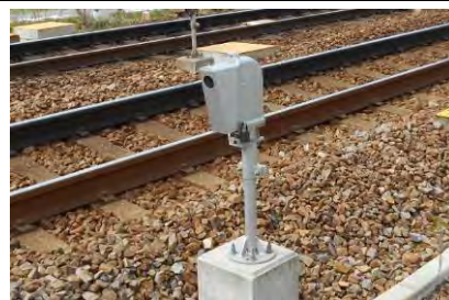
踏切障害物検知装置
