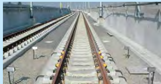
センサー設置状況
