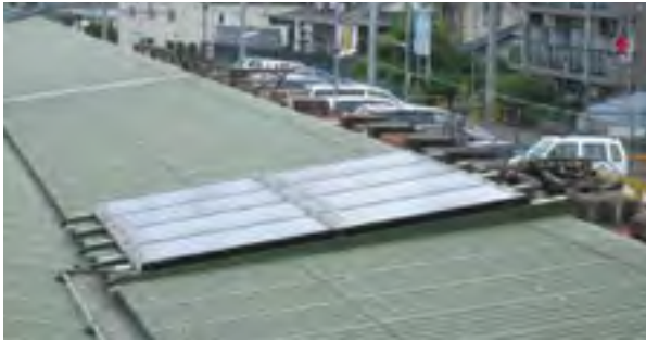
太陽光発電パネル(尾張瀬戸駅)
