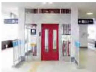
エレベーター
