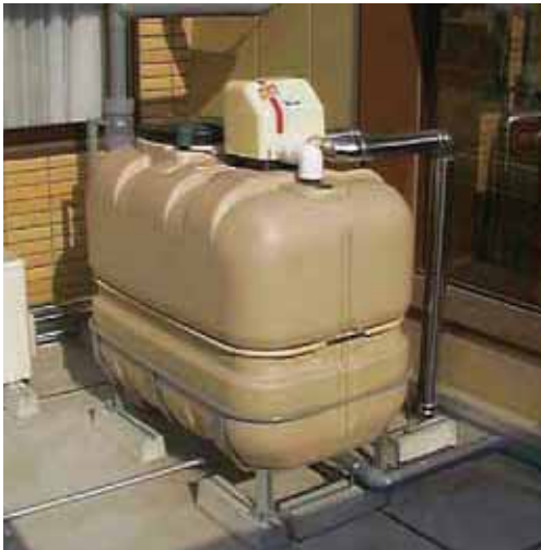
雨水タンク(尾張瀬戸駅)
