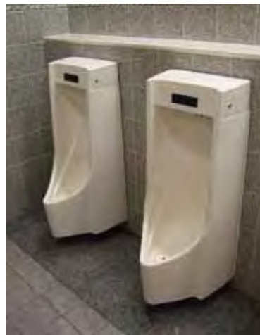
節水トイレ(中部国際空港駅)
