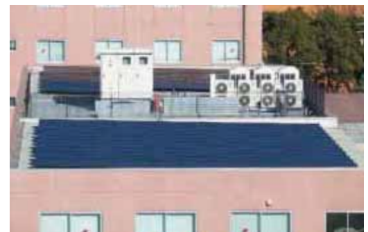
太陽光発電設備
