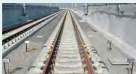
センサー設置状況
