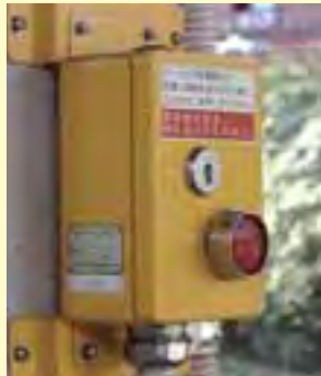
列車非常通報ボタン
