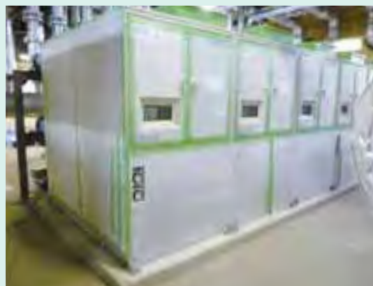
電気高効率水冷チラー
