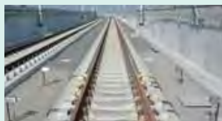
センサー設置状況
