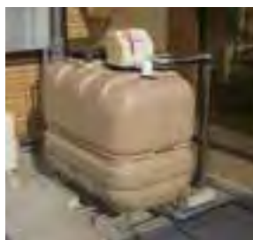
雨水タンク(尾張瀬戸駅)
