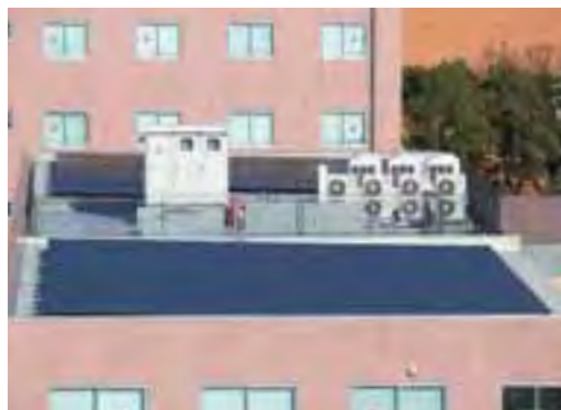
太陽光発電設備
