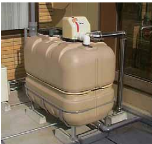
雨水タンク(尾張瀬戸駅)
