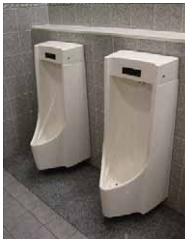
節水トイレ(中部国際空港駅)
