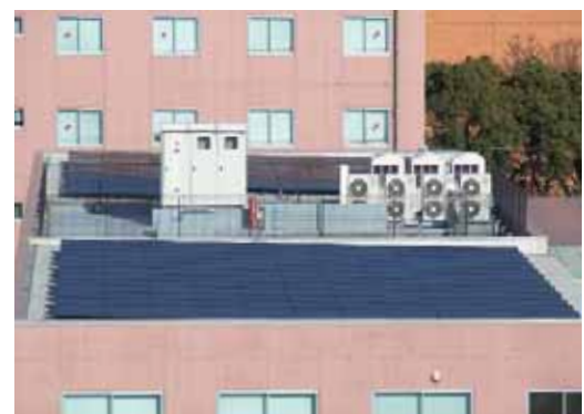
太陽光発電設備
