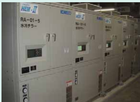
電気高効率水冷チラー
