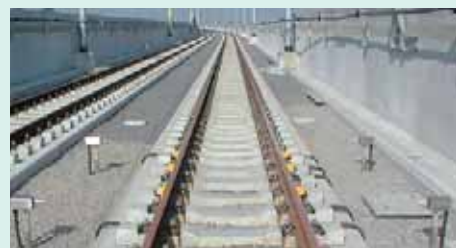
センサー設置状況
