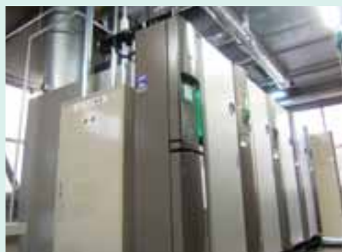
貫流式ガスボイラー
