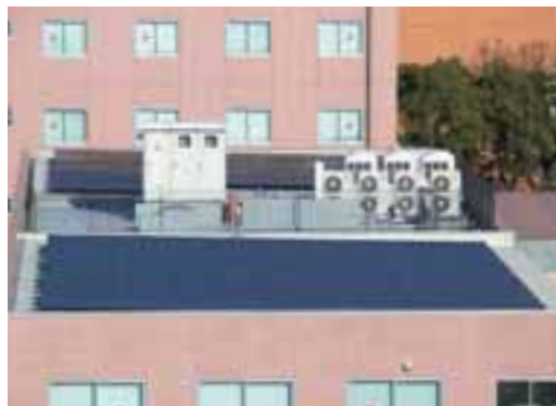
太陽光発電設備
