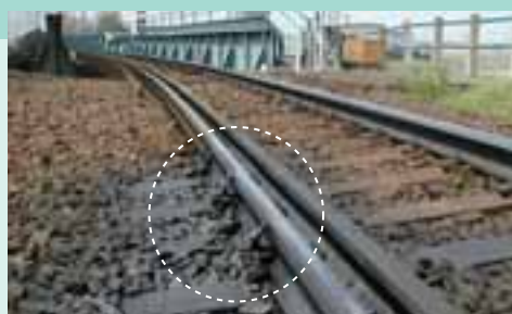
装置設置状況
