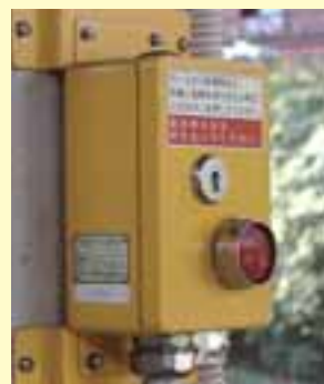
列車非常通報ボタン
