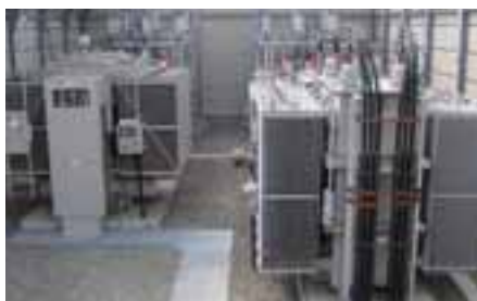
防音壁を設置した犬山変電所
