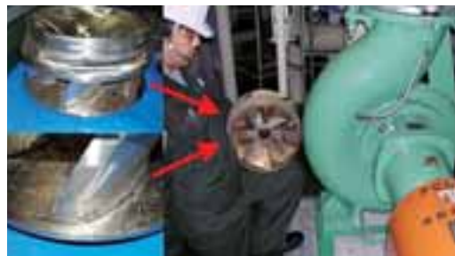
ポンプのインペラカット ……ポンプの羽根車を削ることでエネルギー消費量を抑える
