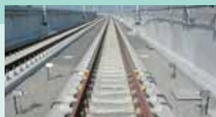
センサー設置状況
