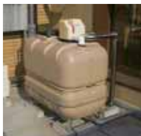
雨水タンク（尾張瀬戸駅）
