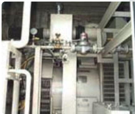
コジェネレーションシステム(名鉄新一宮ビル)
