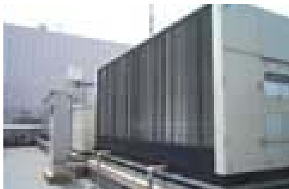
氷蓄熱システム（名鉄新一宮ビル）
