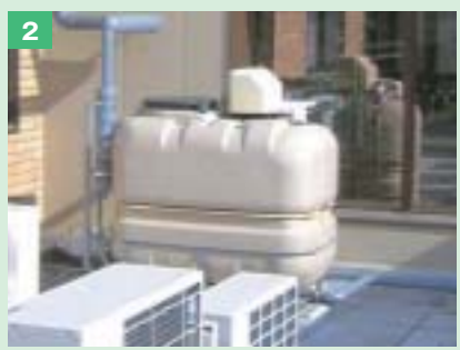
雨水タンク(尾張瀬戸駅)
