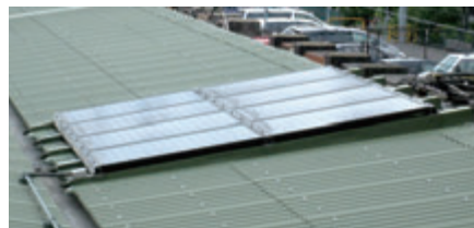
太陽光発電パネル（尾張瀬戸駅）
