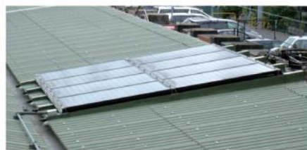
太陽光発電パネル(尾張瀬戸駅)
