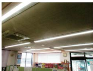
事務室内LED照明器具
