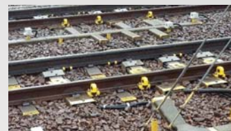
センサー設置状況
