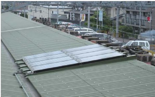
太陽光発電パネル(尾張瀬戸駅)
