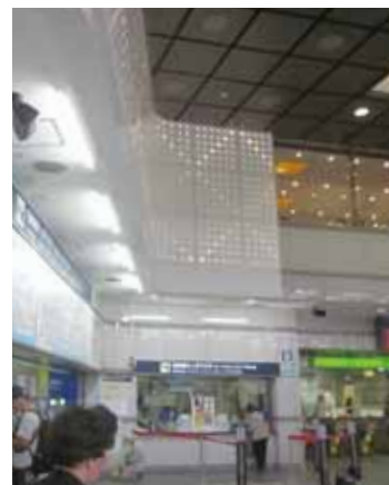
LED照明(金山駅)
