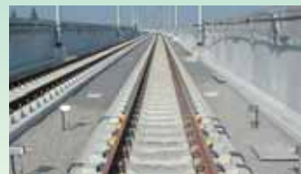
センサー設置状況
