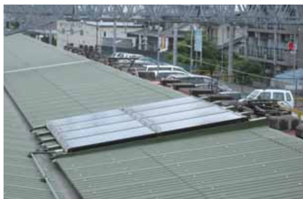
太陽光発電パネル(尾張瀬戸駅)
