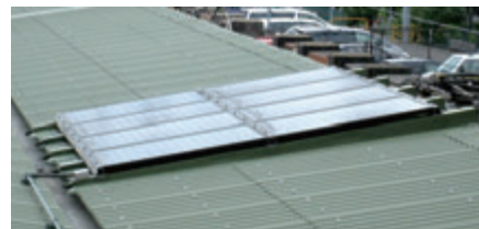
太陽光発電パネル（尾張瀬戸駅）
