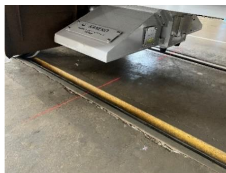
軌道変位モニタリング装置
